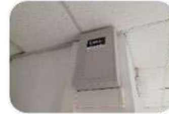
Central de incendios
