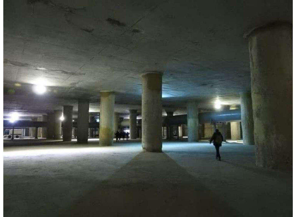
Nivel Instalaciones, tubería impulsión al fondo de la imagen
