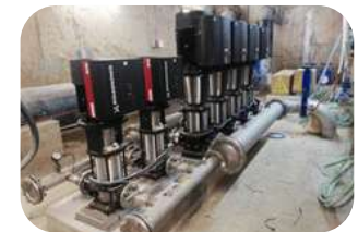
Bombas cámara seca
