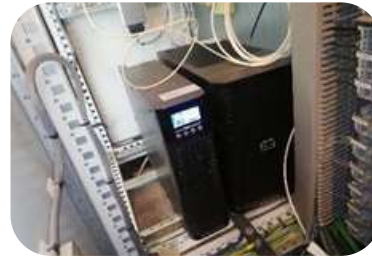
SAI (Sistema de Alimentación Ininterrumpida)
