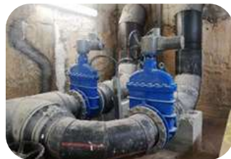
Válvulas de compuerta motorizadas
