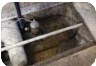
Bombas de achique
