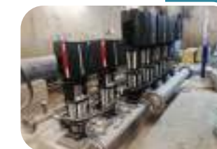
Bombas cámara seca
