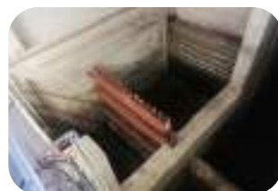
Reja de desbaste de sólidos
