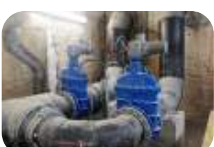
Válvulas de compuerta motorizadas
