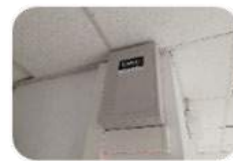
Central de incendios
