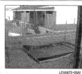
Depósito en un unifamiliar.
